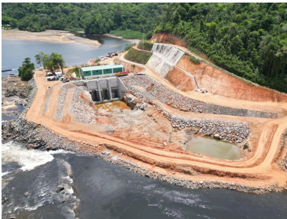
Centrale hydroélectrique de Cafesoca
