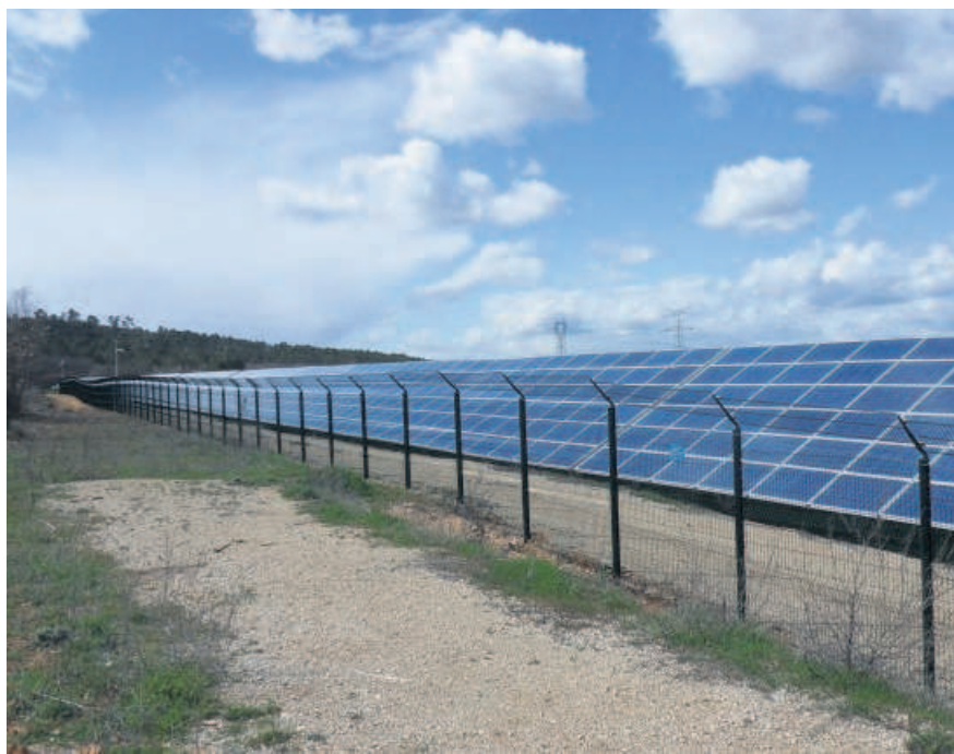
Le parc photovoltaïque de Saint-Thibault-des-Vignes ouvrira fin 2011. D'une puissance de 5 megawatts, il produira assez d'électricité pour faire face à la consommation annuelle des habitants de la commune.
